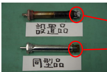
防火ダンパー内にある温度ヒューズ 上：油汚れが付着した設置品 下：新品の同型品
