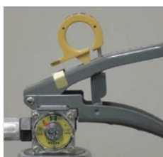
× 安全栓の抜けかけ
